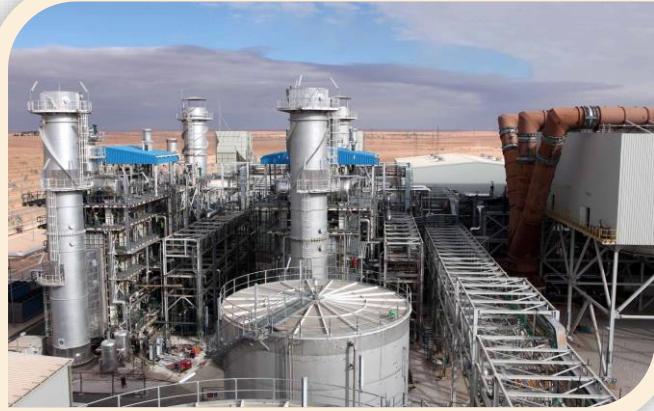
محطة توليد الكهرباء
